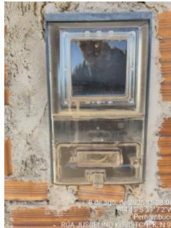
Sem medidor de energia
